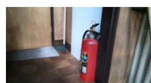
消火器の位置確認
