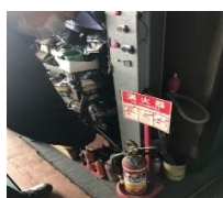
消火器の位置確認
