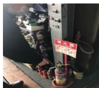
消火器の位置確認
