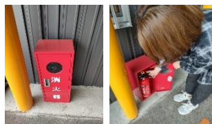
消火器の位置確認
